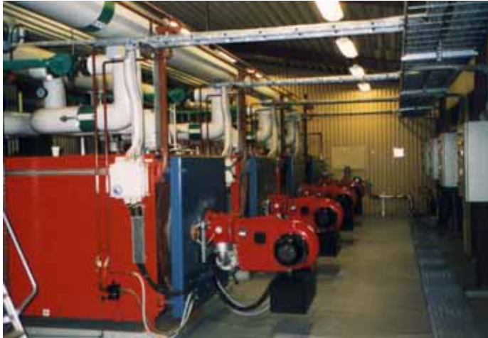
Figur 14. Biogaspanna för värmeproduktion. Foto: SWECO VIAK.
