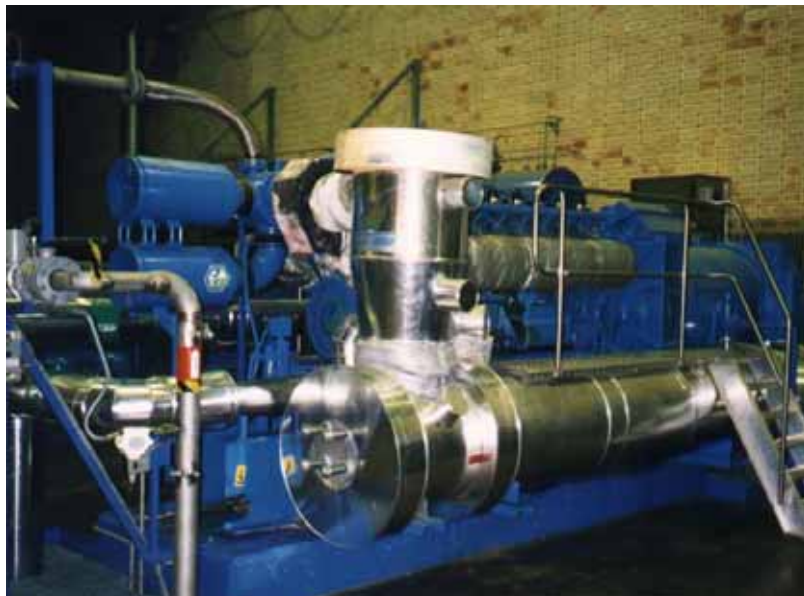
Figur 15. Gasmotor för elproduktion från biogas. Foto: SWECO VIAK.
